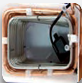
Sistema refrigeración banco de hielo.
